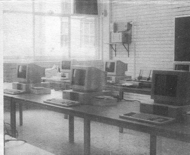
Módulo de Computación ya instalado.
