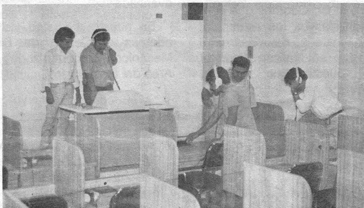
Pruebas del funcionamiento del sistema ya instalado.
