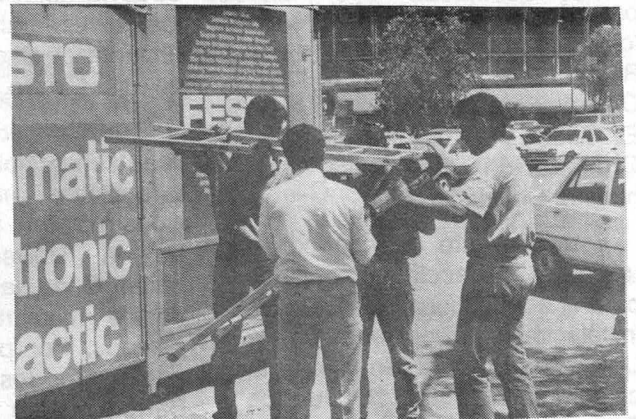
La energía eléctrica y los detalles de instalación se llevaron a cabo por los mismos colaboradores de este Centro.
